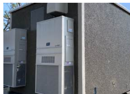
IT & Edge Rooms
